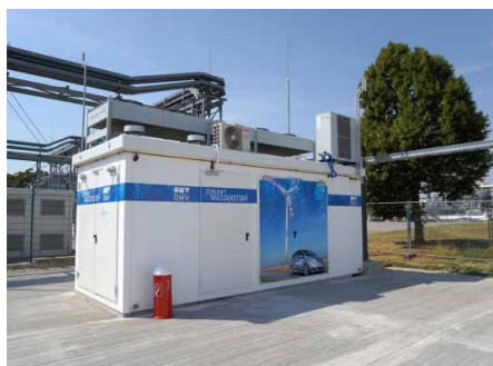
Pilotanlage für das Forschungsprojekt wind2hydrogen: Umwandlung von erneuerbaren Energien in Wasserstoff für die Lagerung und den Transport über das Erdgasnetz, Österreich
